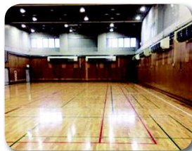
※ 体育場の暖房設備 ～冬場の運動も快適です～
